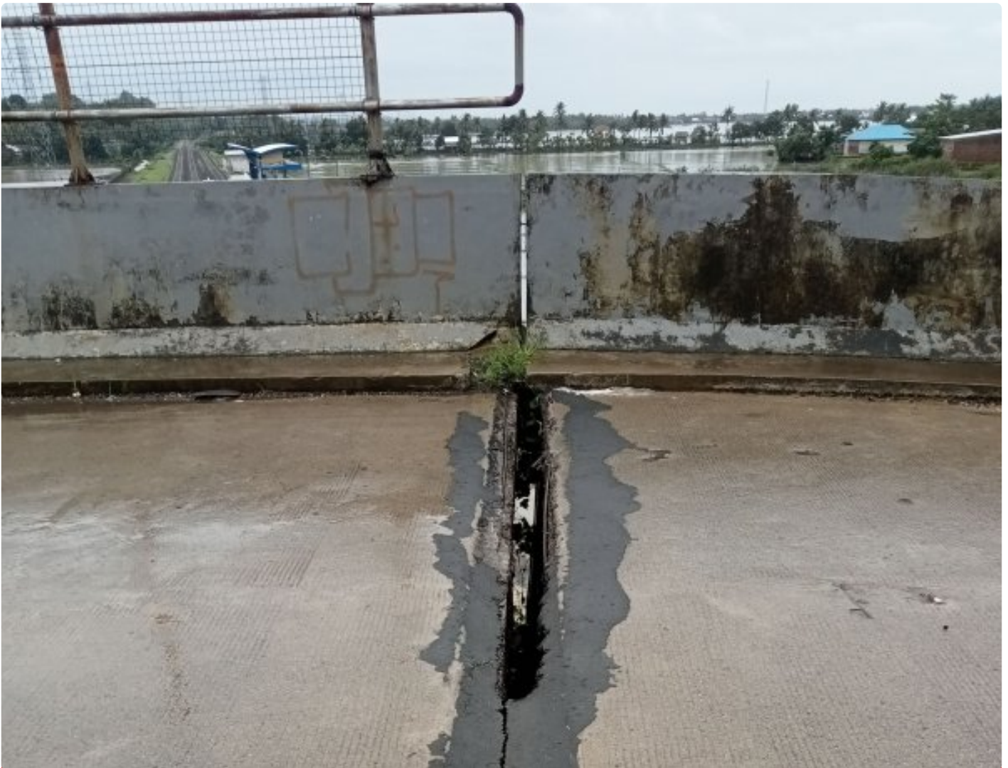
Sambungan jalan fly over Pekkae rusak parah
